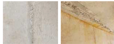
شکاف درز ورقه ای
